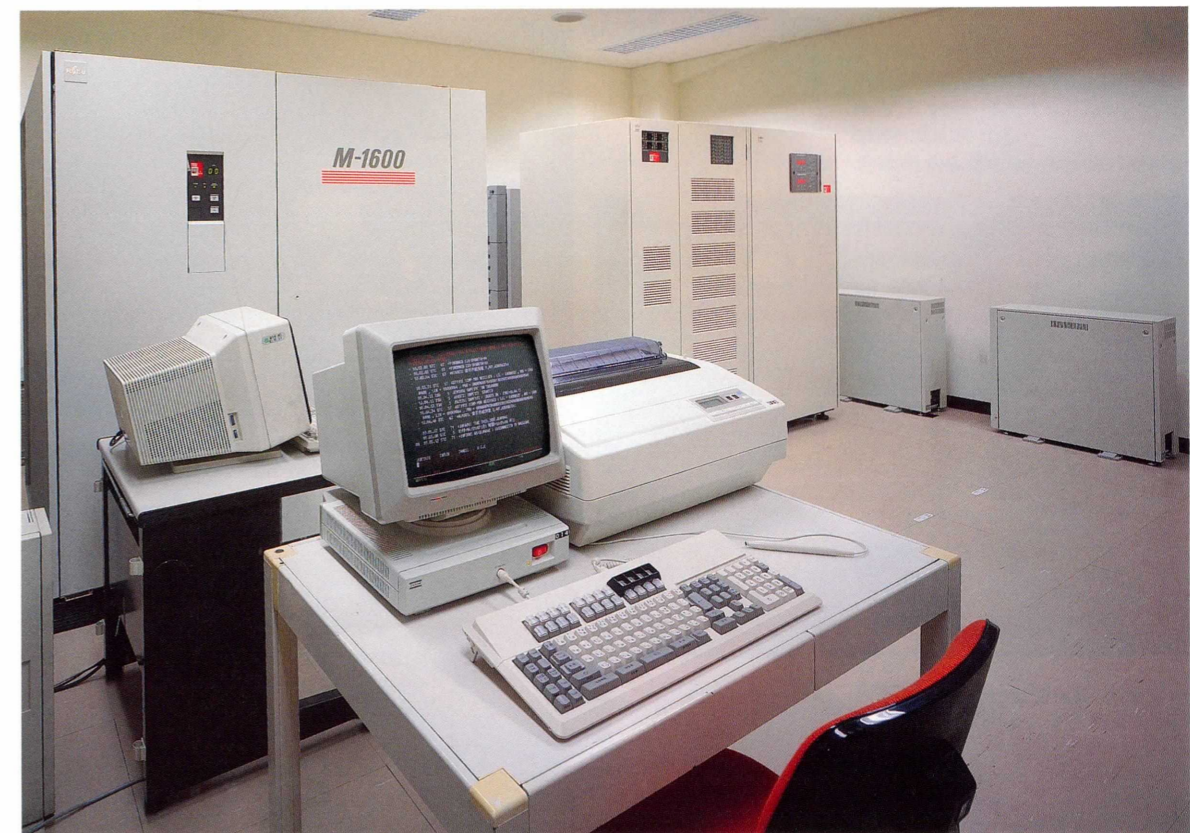
大型コンピュータ室
